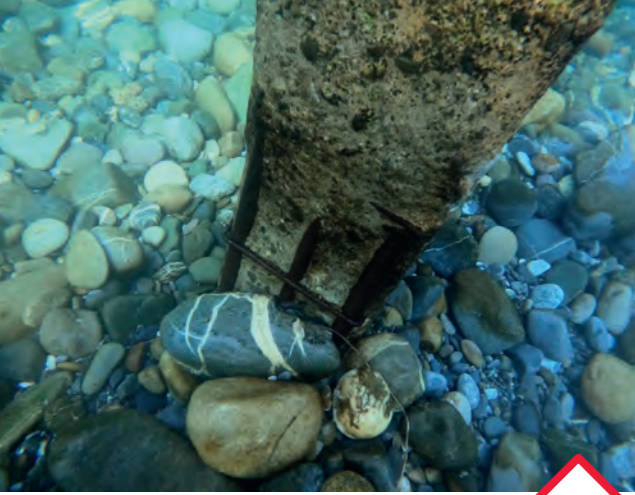
Beschädigungen am Fundament der Schützenfahrbrücke Münsingen
